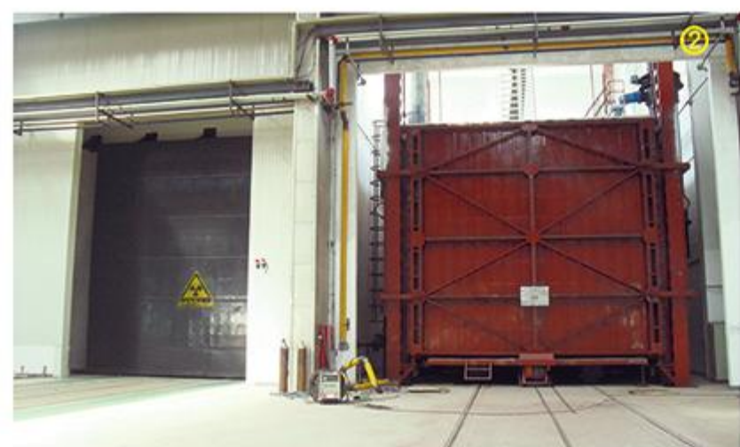
21m×6.8m×7m热处理炉 Heat Treatment Furnace(21m×6.8m×7m )
