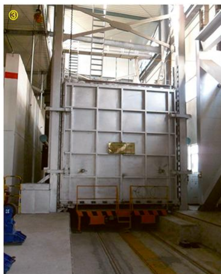
16m×4.7m×5.1m热处理炉 Heat Treatment Furnace(16m×4.7m×5.1m)
